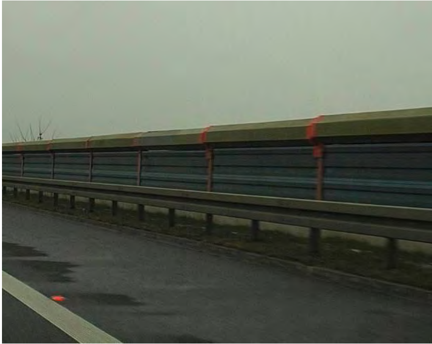
Fot. 1. Przykład zastosowania reduktorów oktagonalnych na istniejących ekranach akustycznych
